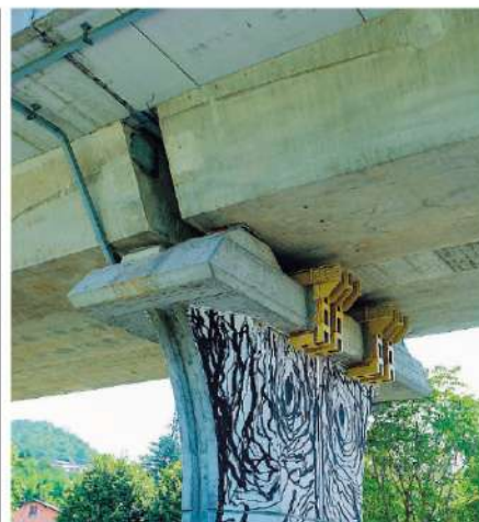
Il cavalcavia è chiuso a camion e bus dall'estate 2017, per gravi problemi strutturali
