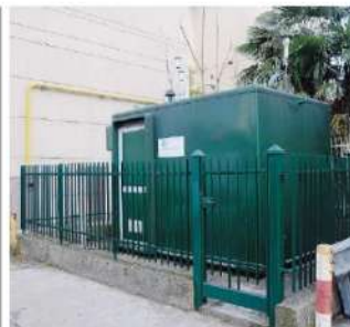
La centralina di rilevamento dell'Arpa, in viale Cattaneo a Como
