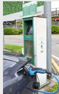
Colonnine di ricarica per auto elettriche
