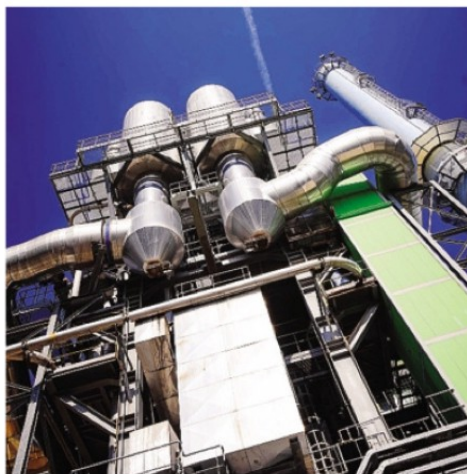
Il termovalorizzatore di Acsm-Agam alle porte di Como
