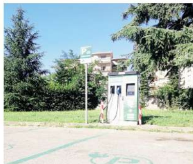
La colonnina elettrica attiva già oggi in via Porta Spinola
