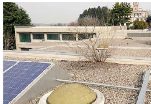
Gli arbusti sul tetto delle scuole rifatto recentemente
