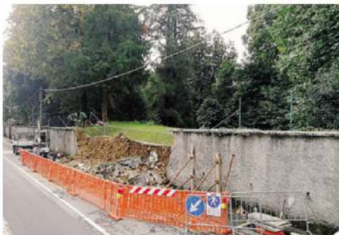
Il muro della storica villa crollato sulla strada
