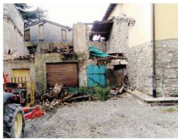
Lo stabile collassato dopo le piogge dei giorni scorsi
