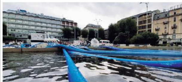
L'idrovora posizionata dalla Protezione Civile in piazza Cavour ha continuato a pompare l'acqua anche nella giornata di ieri
