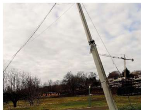
Il palo della Telecom decisamente pendente
