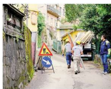
I tecnici intervenuti per la frana in via Santa Marta (BUTTI)
