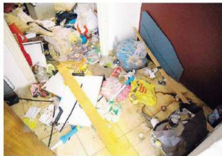
L'interno di un appartamento abbandonato da mesi nel complesso di case comunali di via San Bernardino da Siena. La denuncia si accompagna alla richiesta indirizzata al Comune di Como di eseguire quanto prima i lavori di manutenzione
