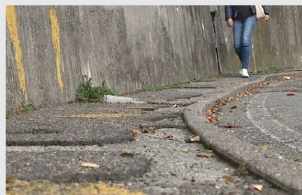
L'evidente stato di degrado in cui versa un marciapiede in Salita Cappuccini
