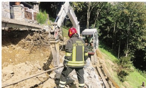
L'ispezione nella zona dove è crollato il muro di contenimento
