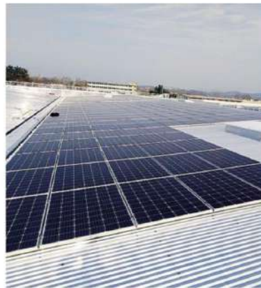
Il grande impianto fotovoltaico
