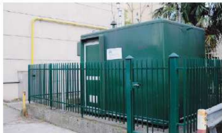
La centralina di Arpa collocata a fianco dell'ingresso del Cao Plinio Secondo, a Como
