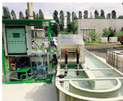
L'impianto progettato da Seam e Politecnico di Milano
