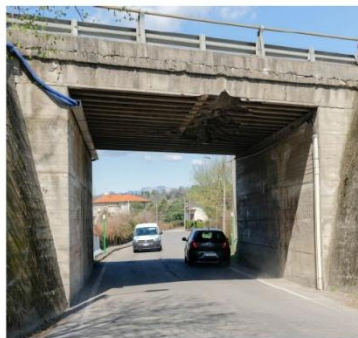
Il ponte della provinciale Novedratese a Carimate, danneggiato lunedì (A. Nassi)
