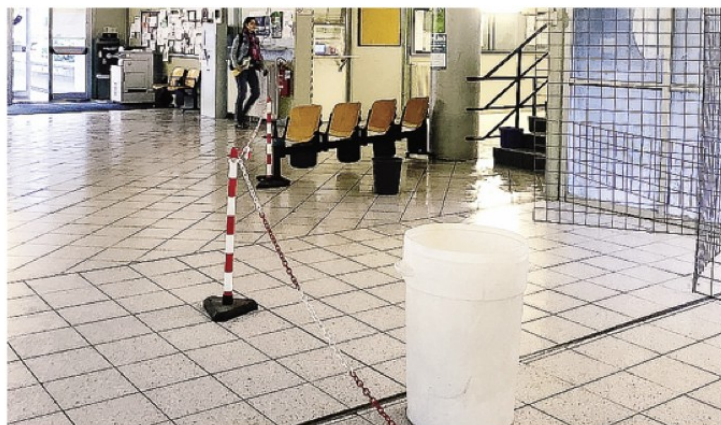
Un secchio all'ingresso dell'istituto per il problema delle infiltrazioni
