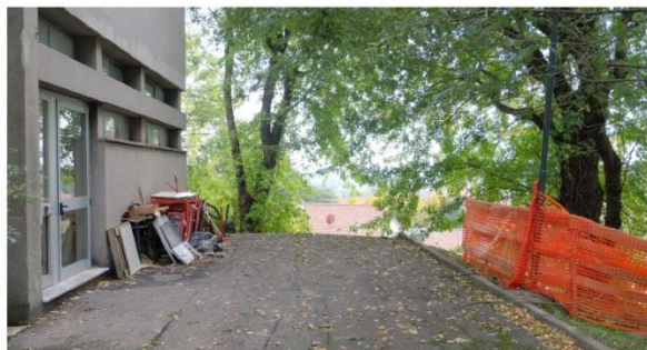
Degrado e lavori in corso alla scuola secondaria di primo grado "Aldo Moro" dove ha sede il plesso di via Picchi a Como
