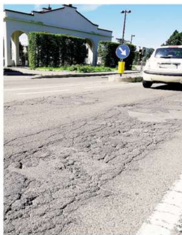
L'asfalto da rifare in viale dei Cipressi ARCHIVIO
