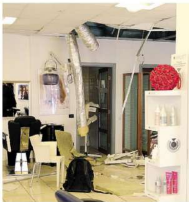
Il controsoffitto sfondato e gli effetti nel negozio "LaBa Acconciature". L'operaio e la parrucchiera al lavoro sono rimasti feriti. BARTESAGHI
