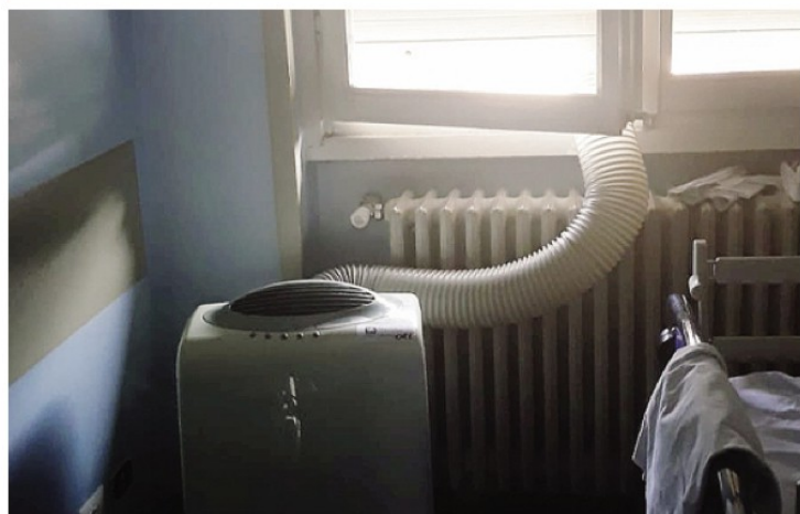
Il condizionatore è in funzione ma la finestra deve restare semiaperta per fare passare lo scarico
